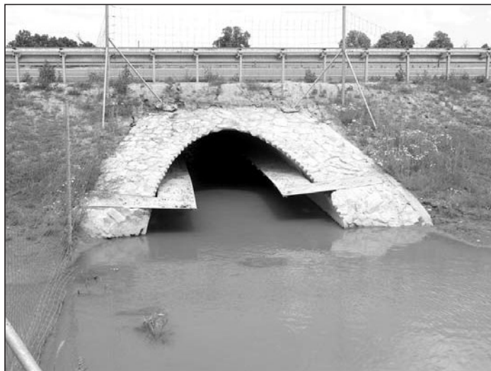
Rys. 7. Przykład przejścia dla płazów oraz małych ssaków pod autostradą A2
